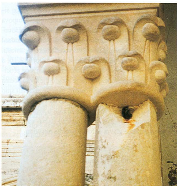
Slika 6. Jedan od oštećenih spojeva stupa i kapitela na katu atrija
