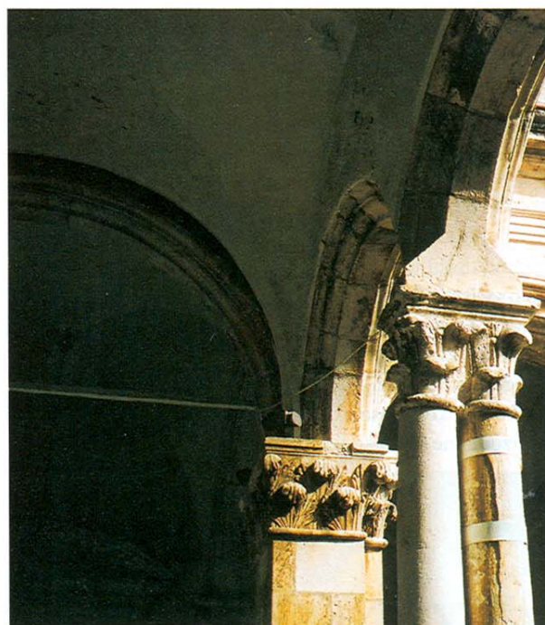
Slika 13. Jedan od jako oštećenih udvojenih stupova na katu
