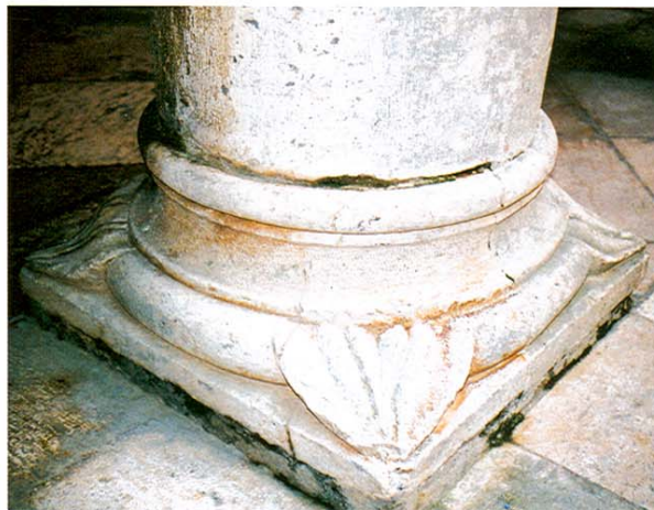
Slika 11. Mortom zapunjeni procjep pri bazi jednog od stupova prizemlja
