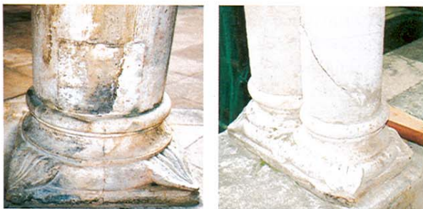
Slika 4. Oštećenja stupova pri bazi: a) kameni umetak u prizemlju, b) lom na katu
