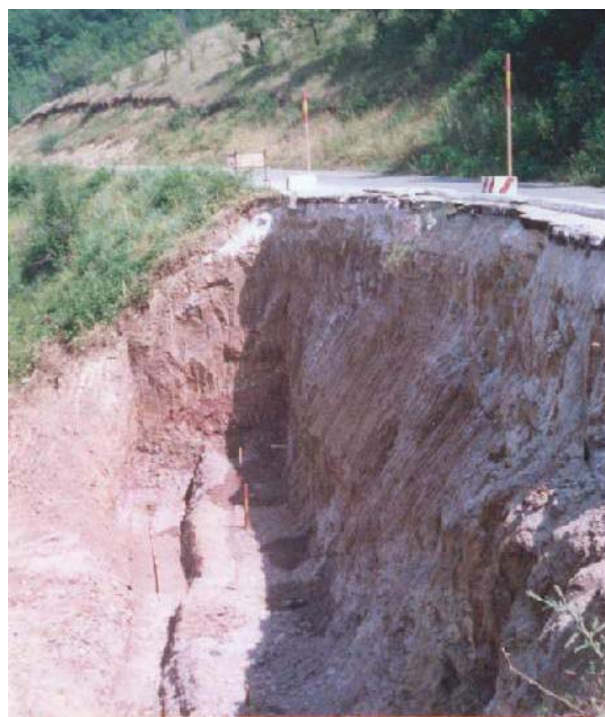
Slika 4. Karakterističan odron uz prometnicu u fazi sanacije
