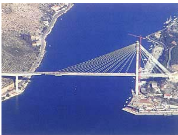
Slika 19. Most tijekom montaže posljednjeg segmenta čeličnog sklopa (montiran je jedan od dva glavna nosača)
