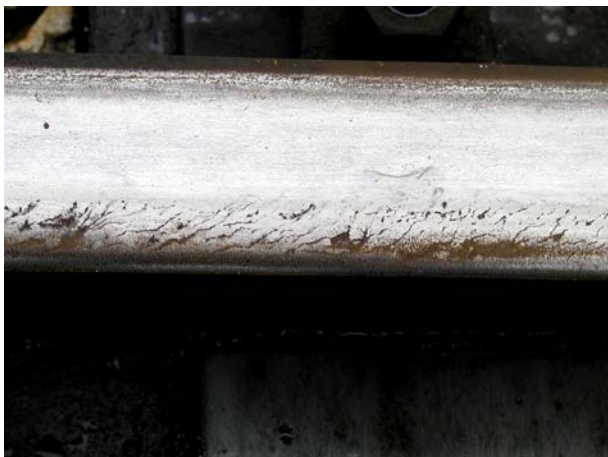
Slika 1. Oštećenja na voznoj površini tračnice
