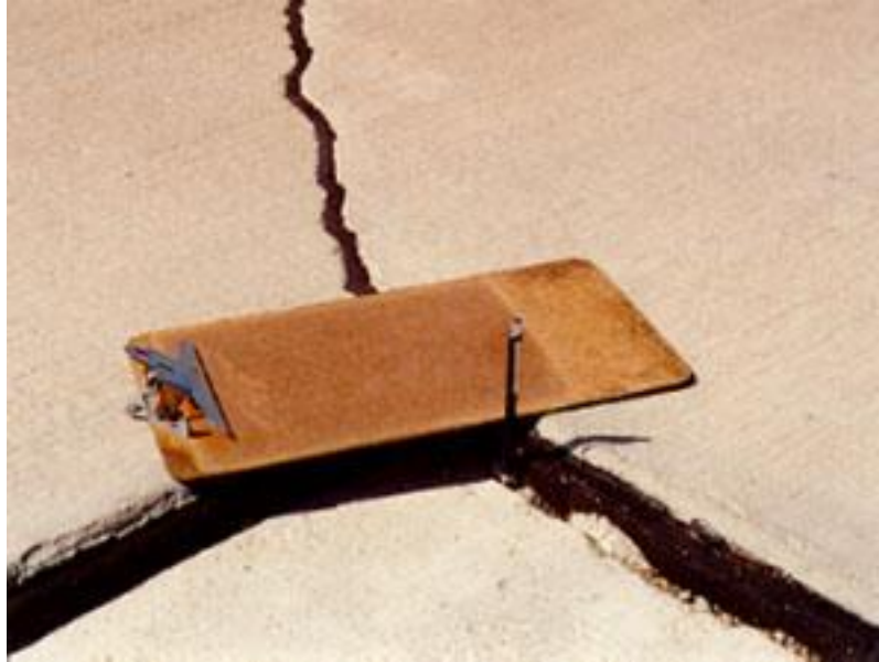
Slika 16. Slijeganje (veliko oštećenje) [15]
