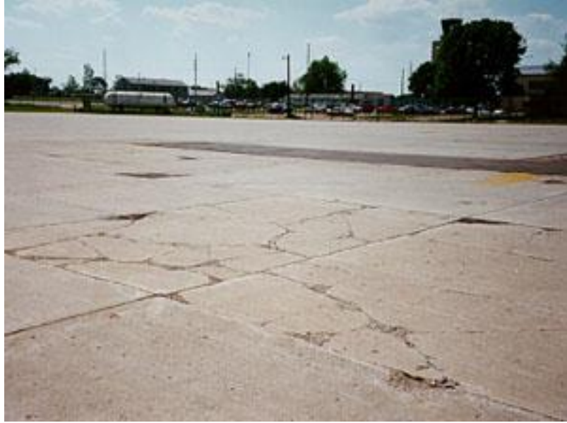
Slika 17. Pukotine koje se presijecaju (veliko oštećenje) [15]
