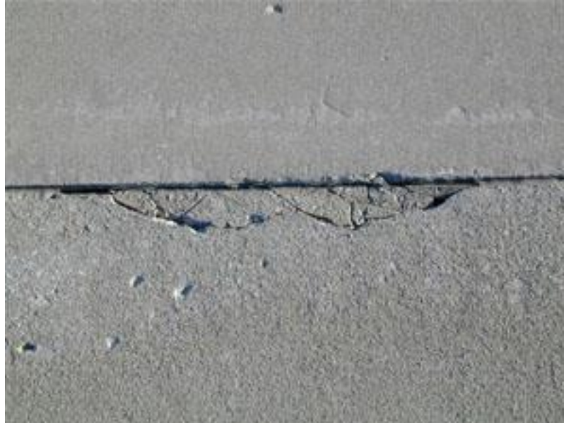
Slika 19. Pukotina uz razdjelnicu (srednje oštećenje) [15]
