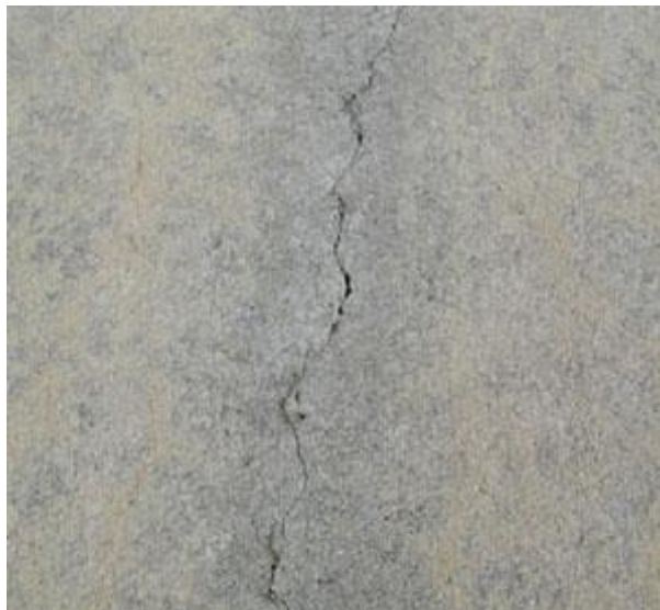
Slika 10. LTD pukotine (malo oštećenje) [15]
