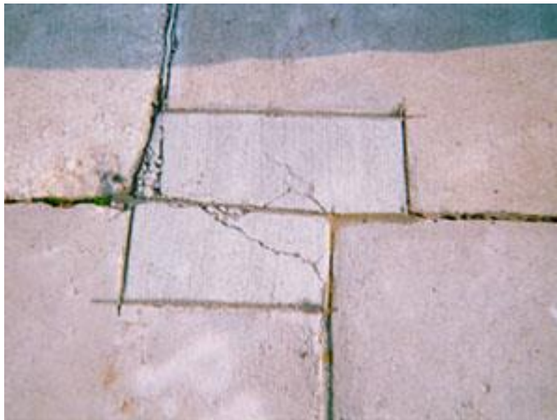
Slika 13. Zakrpa (srednje oštećenje) [14]
