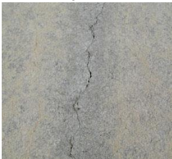
Slika 10. LTD pukotine (malo oštećenje) [15]
