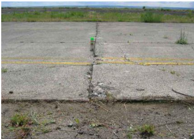
Slika 8. Denivelacija ploča (malo oštećenje) [15]
