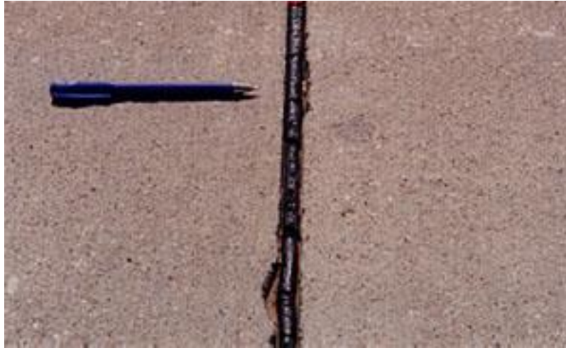
Slika 12. Oštećenje ispune razdjelnica (srednje oštećenje) [15]
