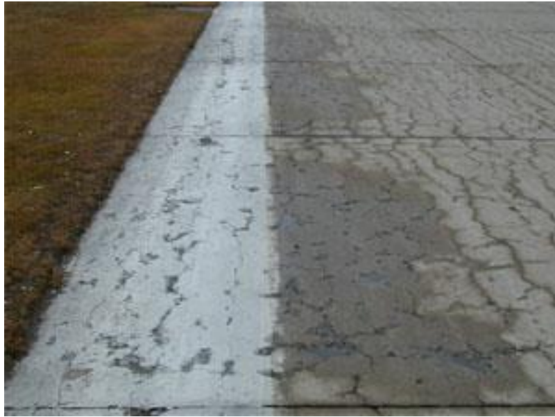
Slika 21. ASR (veliko oštećenje) [15]
