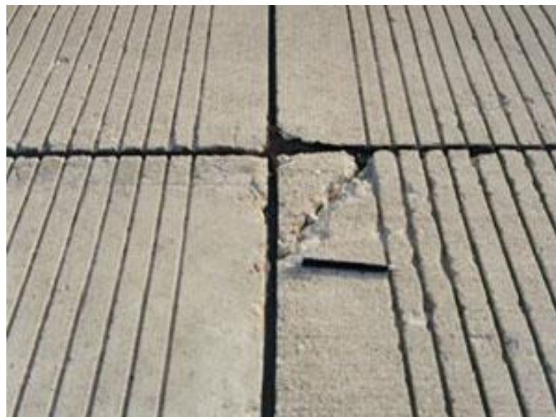
Slika 20. Lom u kutu (malo oštećenje) [15]
