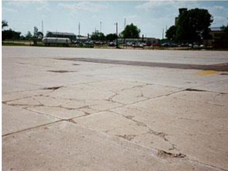
Slika 17. Pukotine koje se presijecaju (veliko oštećenje) [15]
