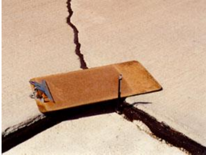
Slika 16. Slijeganje (veliko oštećenje) [15]
