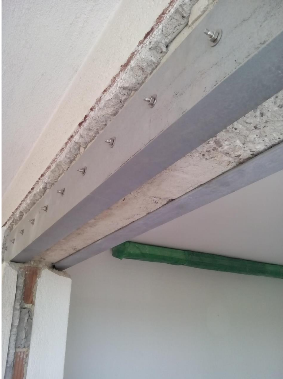
Slika 5. Ojačanje AB grede čeličnim profilom
