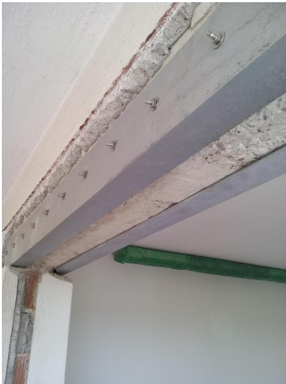
Slika 5. Ojačanje AB grede čeličnim profilom
