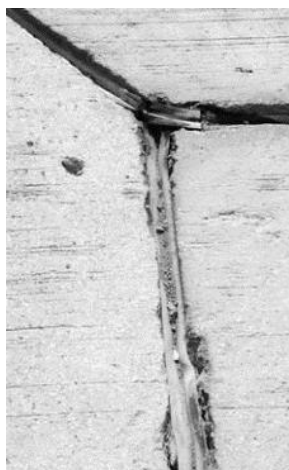
Slika 5. Oštećena ispuna spoja visokog stupnja oštećenja [9]
