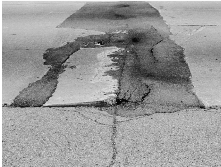
Slika 1. Denivelacija betonske ploče visokog stupnja oštećenja [9]
