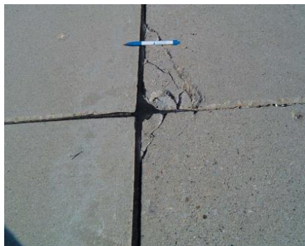
Slika 14. Visoki stupanj oštećenja odlamanja betona kuta ploče[8]
