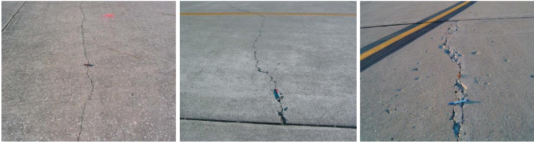
Slika 3: Nizak, srednji i najviši stupanj oštećenja uzdužnih i poprečnih pukotina [8]
