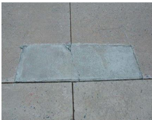
Slika 6. Mala zakrpa srednjeg stupnja oštećenja [8]
