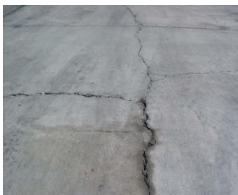
Slika 11. Visoki stupanj oštećenja tipa lom ploče [8]
