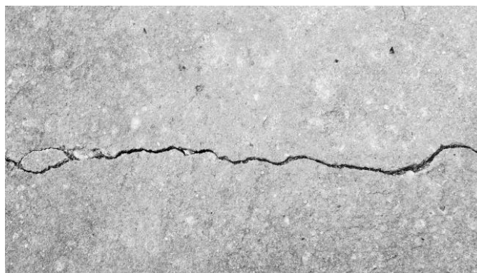
Slika 12. Pukotina nastala procesom skupljanja betona [12]
