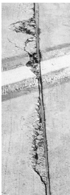
Slika 13. Pukotina duž spoja [9]
