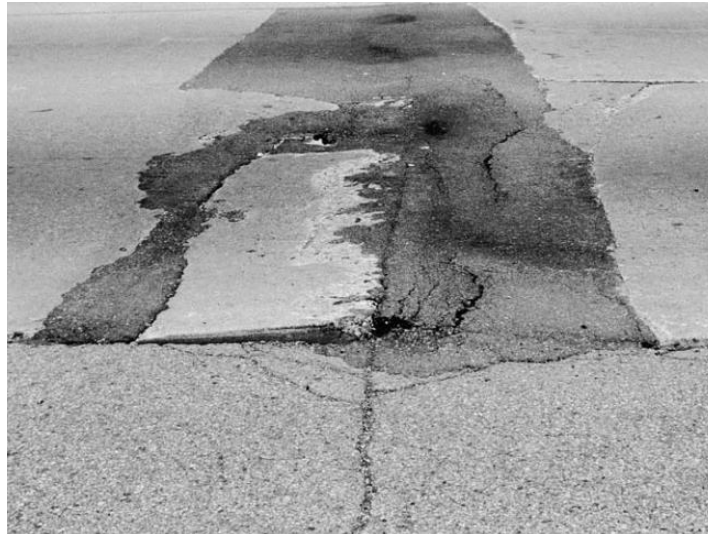
Slika 1. Denivelacija betonske ploče visokog stupnja oštećenja [9]
