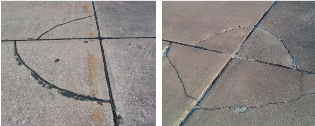
Slika 2. Nizak (lijevo) i srednji (desno) stupanj oštećenja kuta ploče [8]
