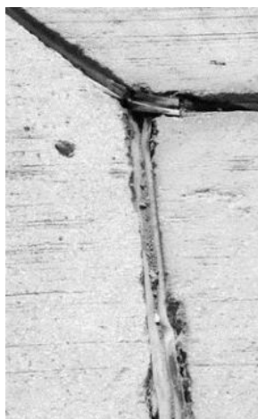
Slika 5. Oštećena ispuna spoja visokog stupnja oštećenja [9]
