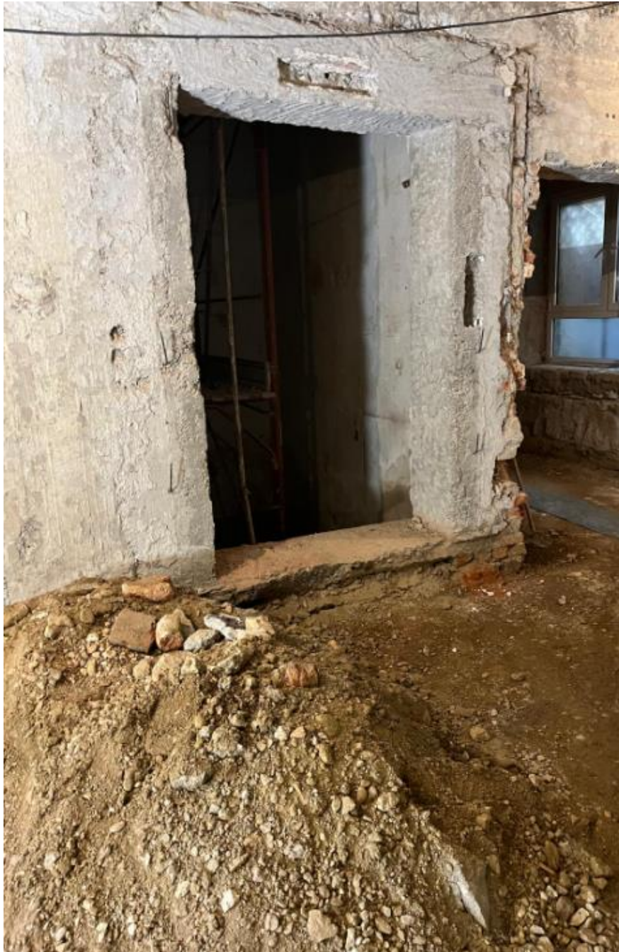
Slika 46.: Nezaštićeno okno dizala
