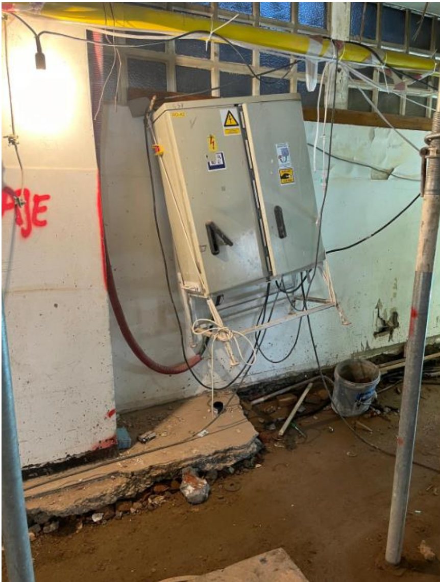
Slika 45.: Nepravilno postavljen ormarić za struju
