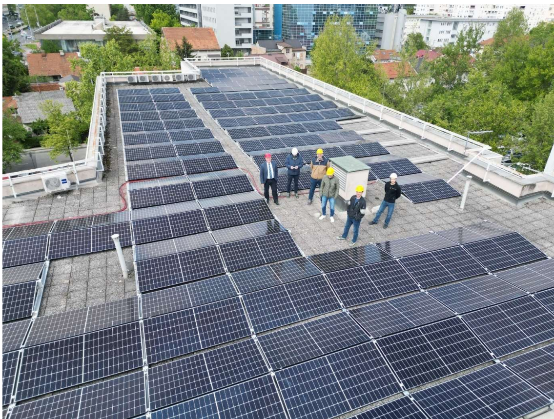
Slika 2.: Solarni paneli na krovu zgrade (Fakultet elektrotehnike i računarstva, 2024)
