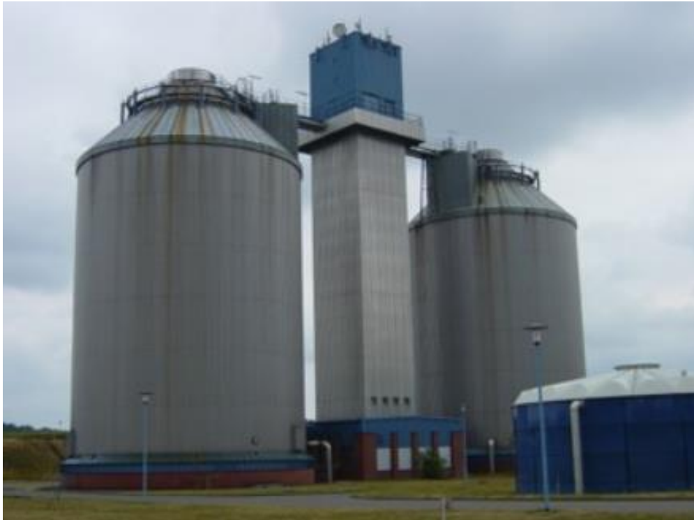
Slika 4: Anaerobni digestor (Izvor:[6])
