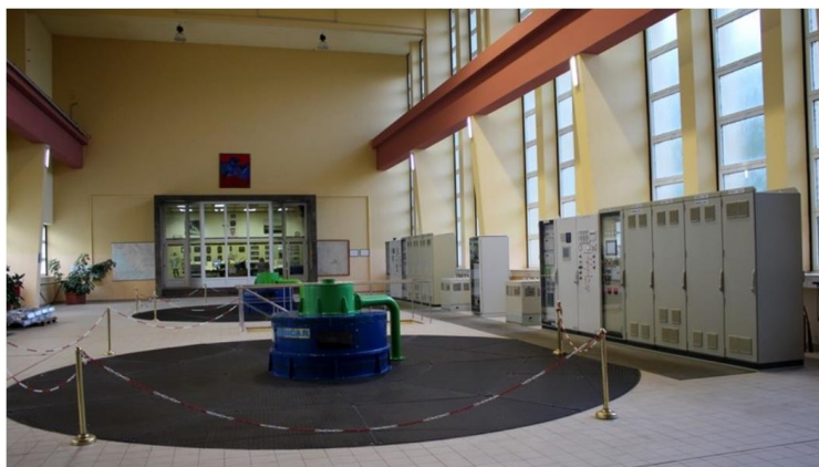
Slika 5: Unutrašnjost strojarnice HE Peruća (Izvor: [9])
