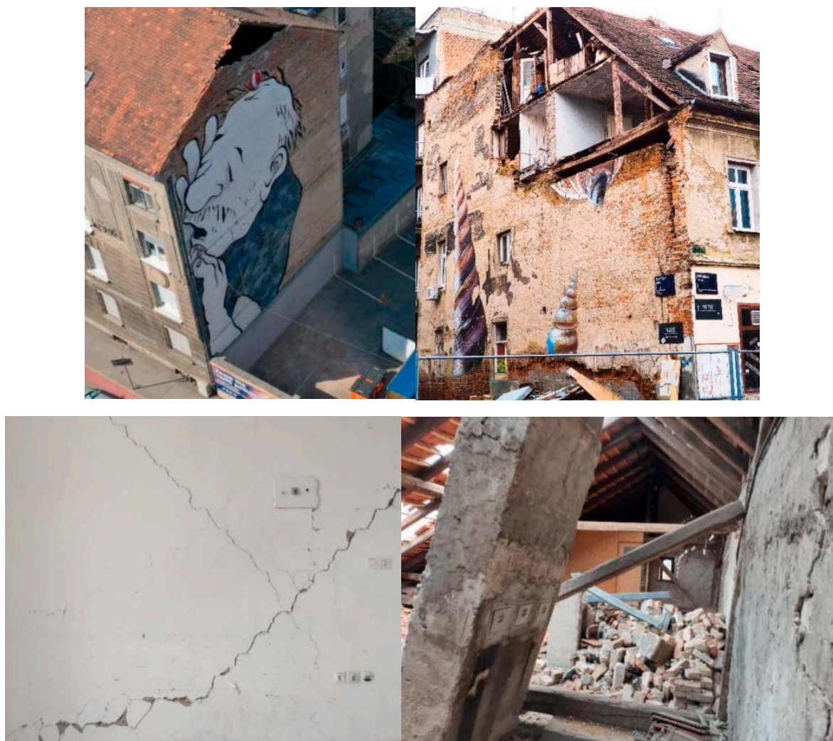
Slika 11: Primjer vanjskih i unutarnjih oštećenja u Zagrebu (2)
