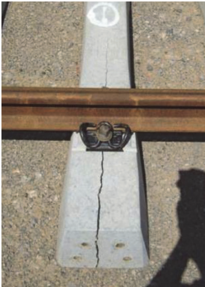
Slika 6. Uzdužna pukotina na betonskome pragu [5]
