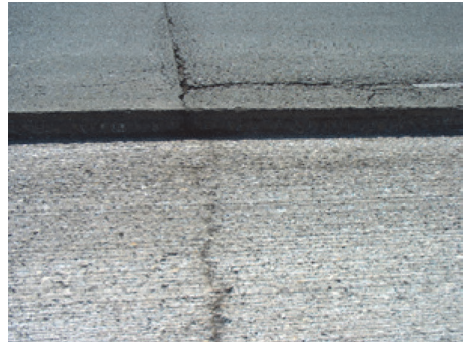
Slika 3. Poprečna i uzdužna pukotina [4]
