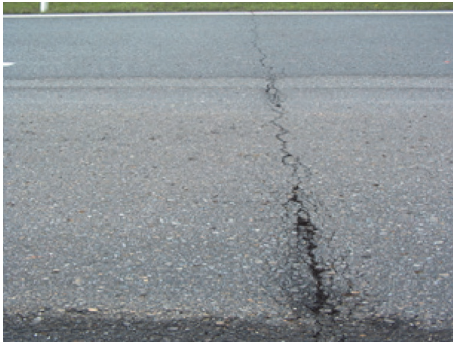
Slika 2. Izražajna strukturna pukotina [4]
