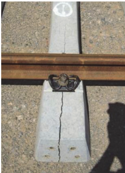
Slika 6. Uzdužna pukotina na betonskome pragu [5]
