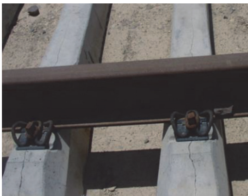
Slika 7. Uzdužna pukotina na betonskome pragu
