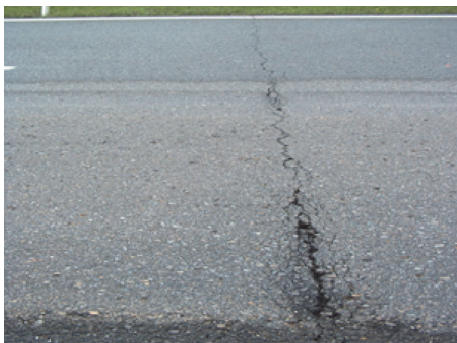
Slika 2. Izražajna strukturna pukotina [4]
