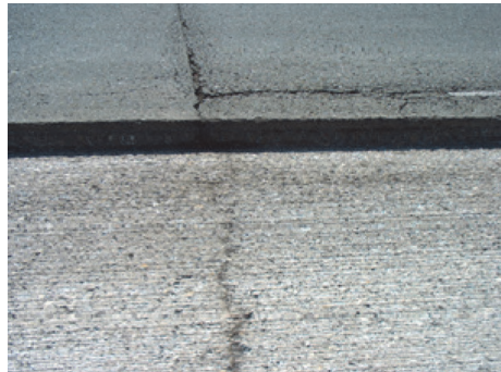
Slika 3. Poprečna i uzdužna pukotina [4]
