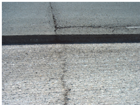
Slika 3. Poprečna i uzdužna pukotina [4]
