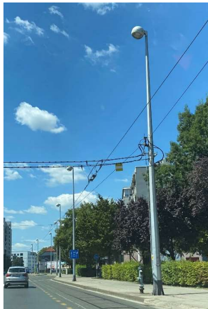
Slika 23.: Rasvjetni stup na koji je spojena tramvajska mreža u Dubravi (Izvor: autor)
