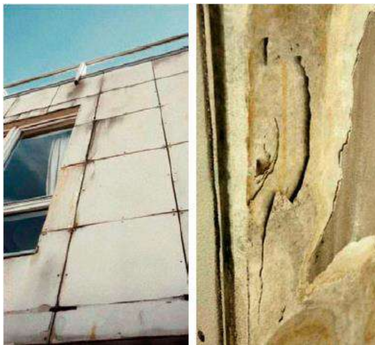
Slika 27: Prikaz oštećenja fasadne obloge zbog prevelike količine vlage ( Izvor:[3] )
