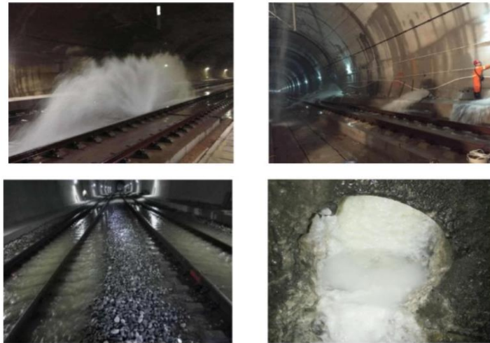
Slika 17 A) Ulazak vode u tunel, B) Ulazak vode kroz bočne zidove, C) Nagomilavanje vode na posteljici, D) Blokiranje drenažnog sustava pojavom leda (Izvor: [17]).
