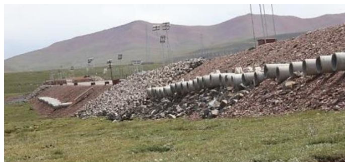
Slika 8 Ventilacijske cijevi (Izvor: [9])
