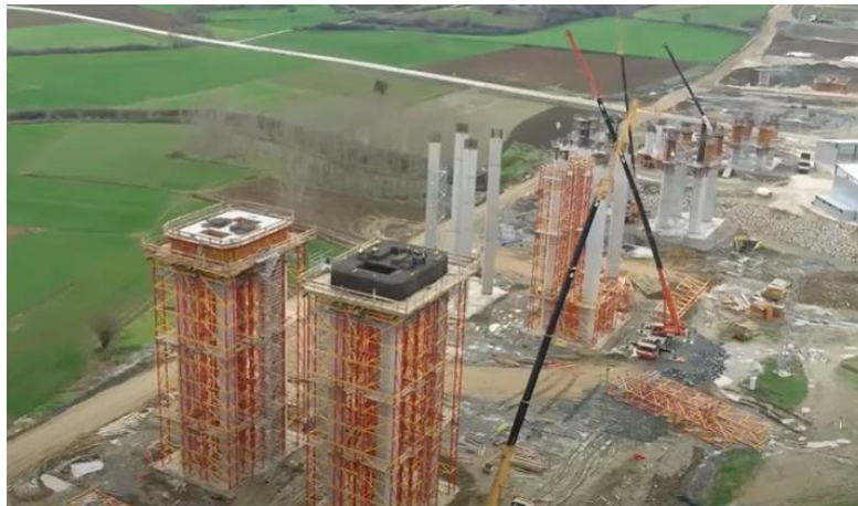
Slika 44.: Gradnja stupova pristupnog vijadukta gdje se vidi korištenje puno oplata, skela i dizalica
