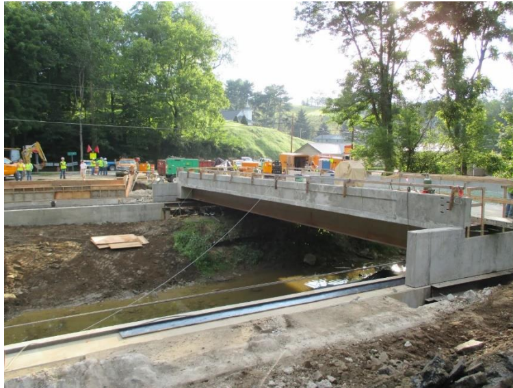
Slika 14.: Klizanje rasponske strukture mosta u Zapadnoj Virginiji, SAD (Izvor: West Virginia's Basnetville Bridge Lateral Slide , 2016.)
