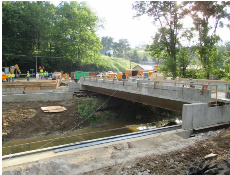
Slika 14.: Klizanje rasponske strukture mosta u Zapadnoj Virginiji, SAD (Izvor: West Virginia's Basnettsville Bridge Lateral Slide , 2016.)
