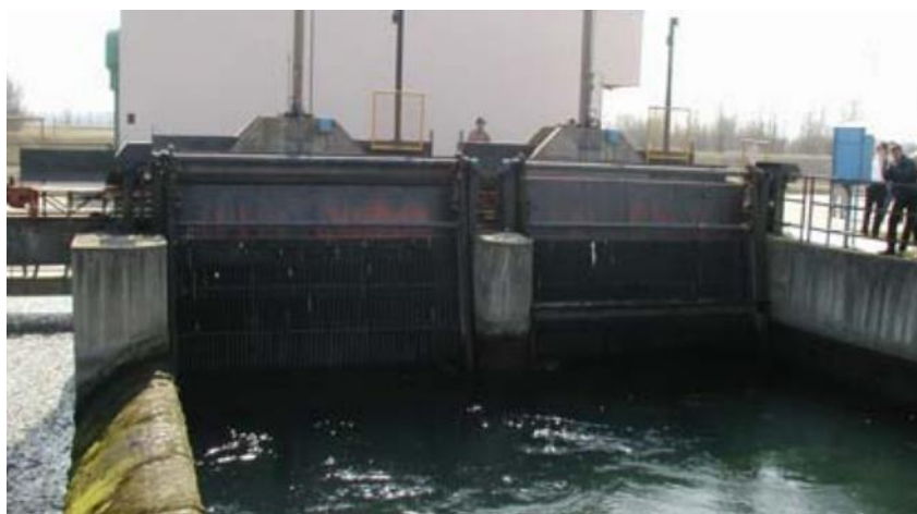
Slika 7.: Pločasti zatvarači na ulazu u malu HE Varaždin [6]
