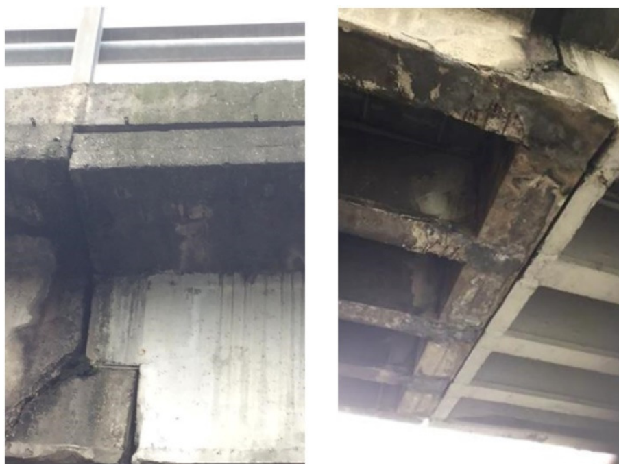
Slika 53.: Detalji oštećenja nadvožnjaka
