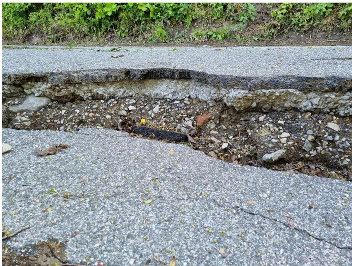
Slika 6 Pukotine u čeonoj zoni klizišta (Izvor: [1])
