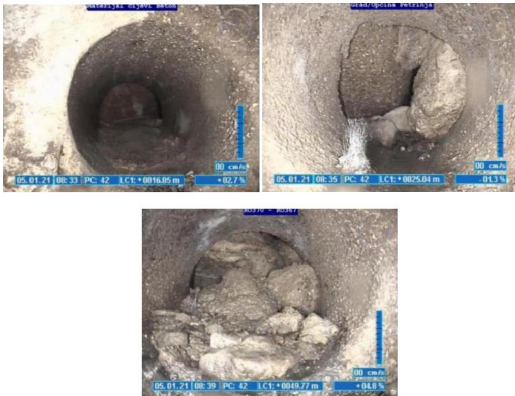
Slika 10. Urušavanje priključaka na sustavu odvodnje u Ulici V.Nazora
