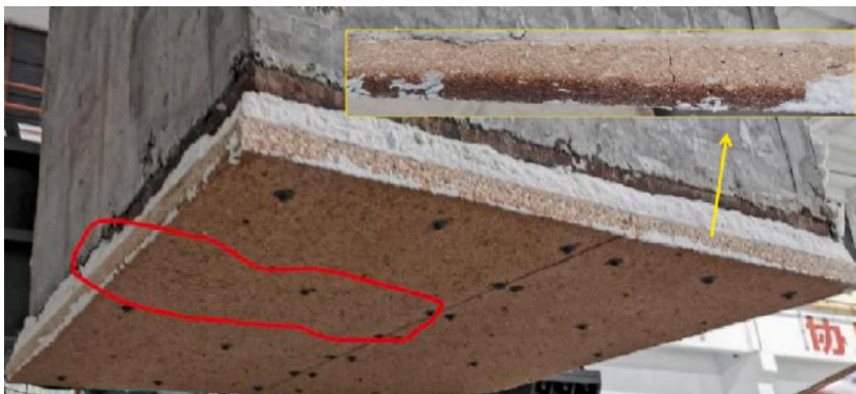
Slika 39. Izgled zaštitnih ploča na bazi vermikulita nakon izlaganja djelovanju visokih temperatura s označenim pukotinama [100]
