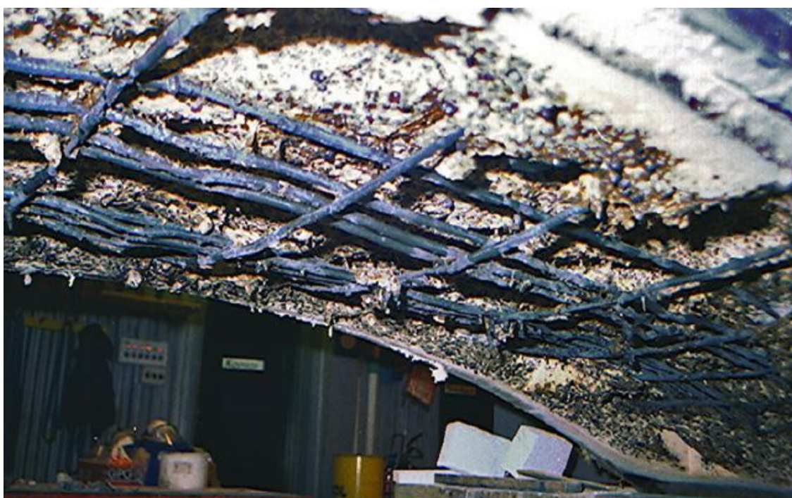
Slika 19. Element Great Belt tunela nakon požara – posljedice eksplozivnog odlamanja betona sekundarne obloge [66]
