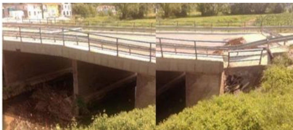
Slika 4. Most „Đurmanec“ nakon gubitka stabilnosti
