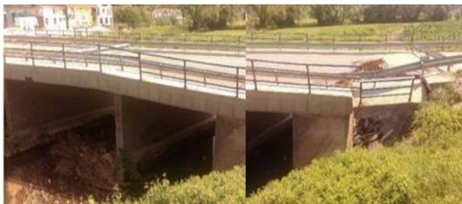
Slika 4. Most „Đurmanec“ nakon gubitka stabilnosti
