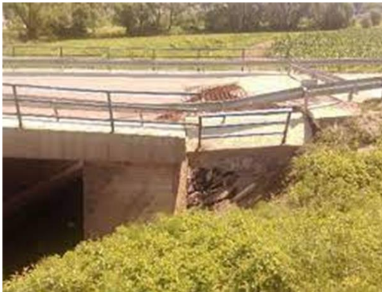
Slika 2 Most „Đurmanec“ nakon oštećenja
