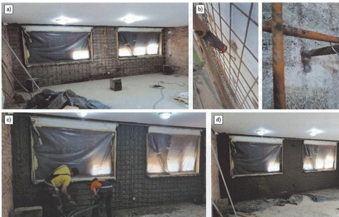
Slika 52 Pojačanje zida torkretiranjem: a) postavljena armatura; b) sidrenje i povezivanje mrežom; c) prvi sloj torkreta; d) drugi sloj torkreta [10]
