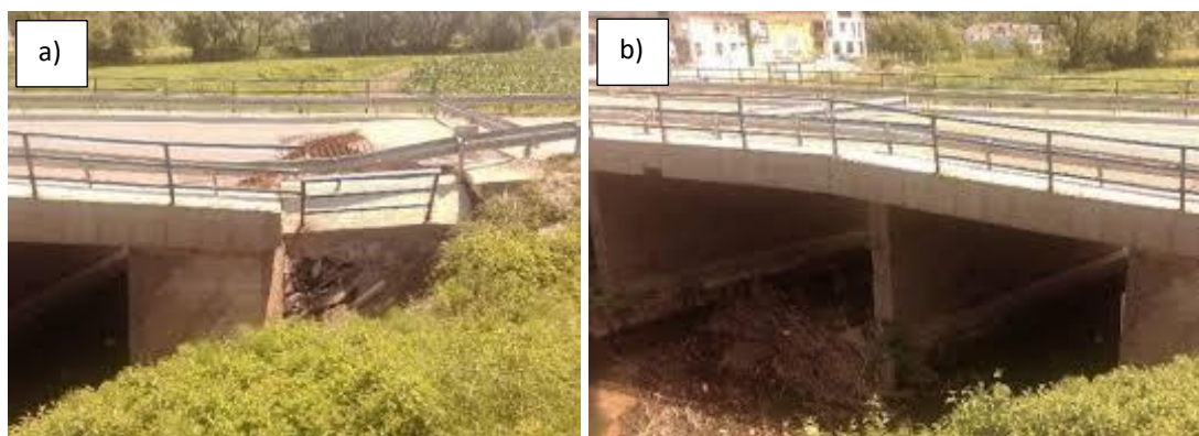
Slika 5.: Most Đurmanec: a) erozija obale iza upornjaka; b) nagomilani plutajući nanos u središnjem otvoru mosta (Izvor: [11])
