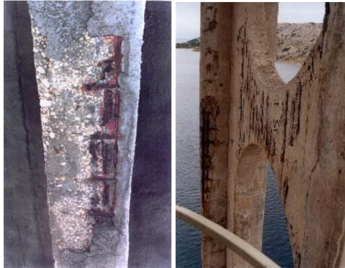
Slika 16.: Propadanje AB konstrukcija uz obalu; Paški most (lijevo) i Krčki most (desno) (Izvor: [19])
