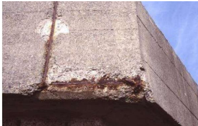
Slika 15.: Korozija uzrokovana karbonatizacijom na AB gredi (Izvor: [17])
