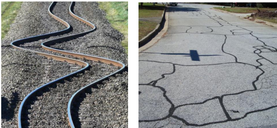
Slika 6.: Oštećenja željeznica (lijevo) i kolnika (desno) zbog ekstremnih temperatura (Izvor: [6])
