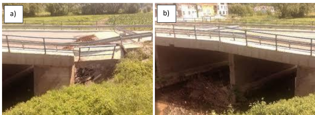
Slika 5.: Most Đurmanec: a) erozija obale iza upornjaka; b) nagomilani plutajući nanos u središnjem otvoru mosta (Izvor: [11])
