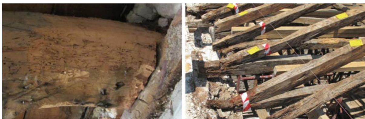
Slika 40. Primjer oštećenja oslonca veznih greda na nosivim zidovima [12]
