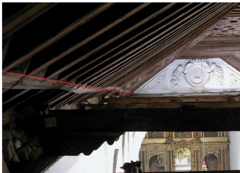
Slika 41. Prikaz nejednolike deformacije krovnih ravnina [15]
