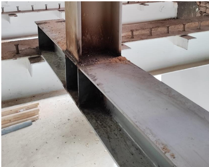
Slika 52. "HEA" profil greda oslonjena na "IPE" profil grede pridržanja stropne AB ploče
