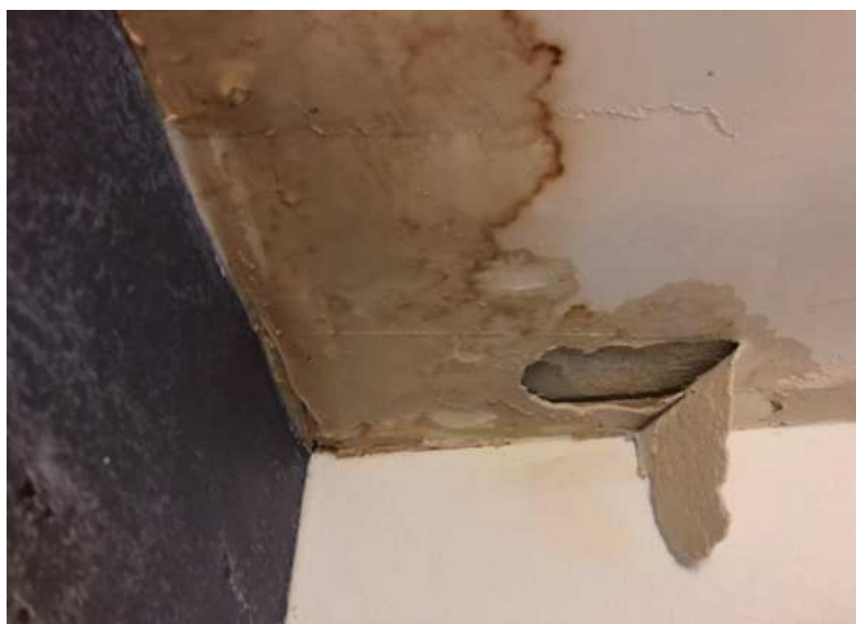
Slika 10.: Oštećenje konstrukcije od vlage
