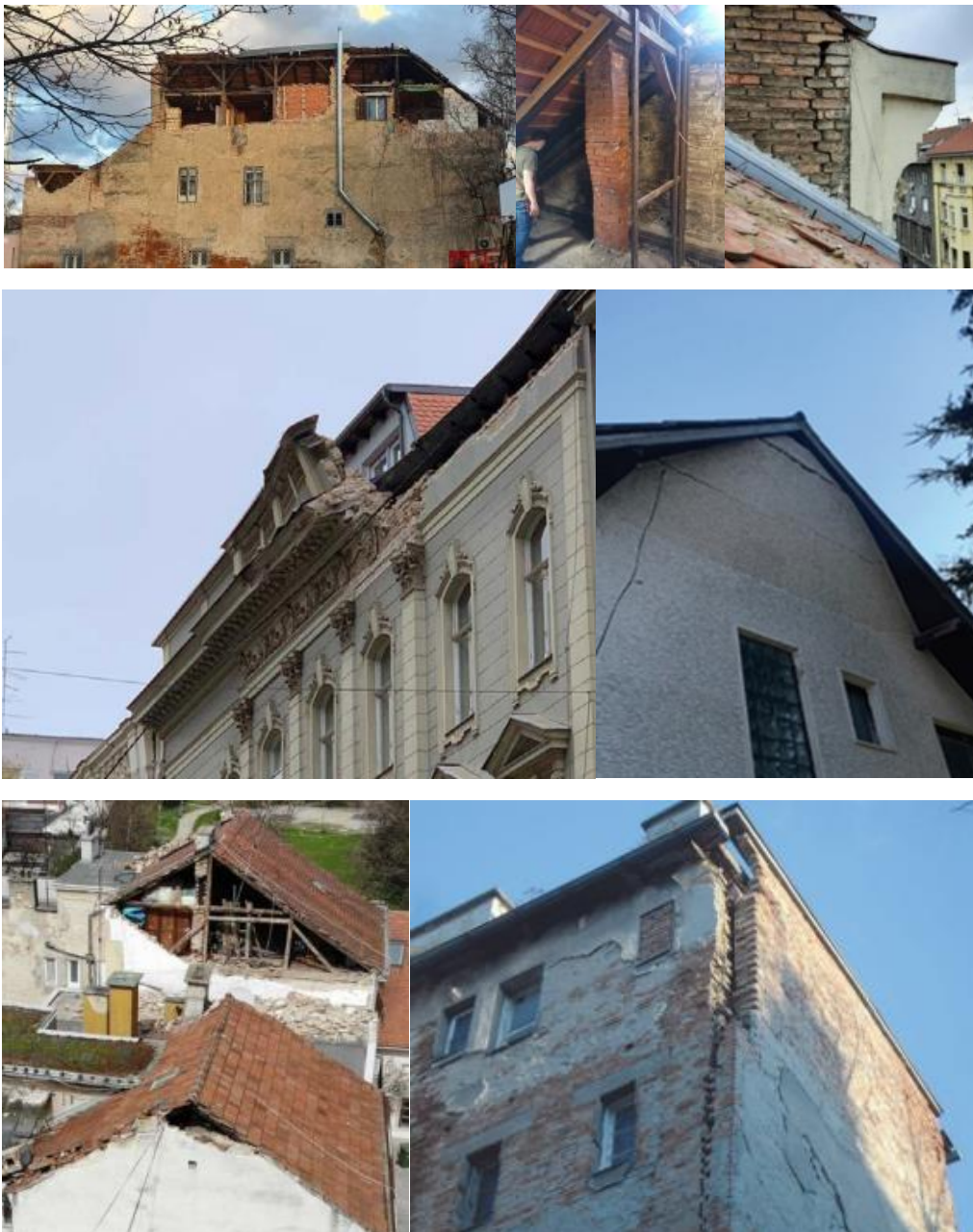
Slika 15. Primjer otkazivanja zidova izvan ravnine na realnim zgradama [4] [9]
