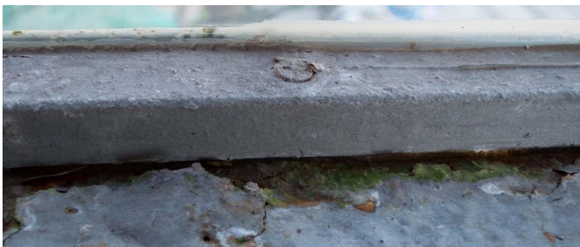
Slika 21.: Korozija u udubini (Izvor:[7])
