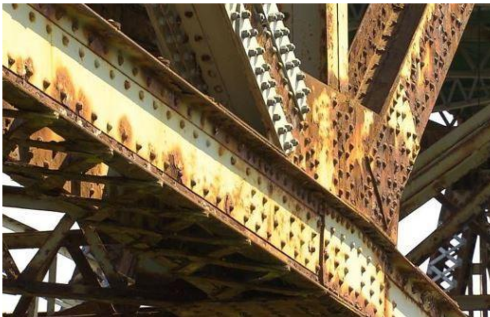
Slika 3.: Primjer hrđanja čelične konstrukcije (Izvor: [21])
