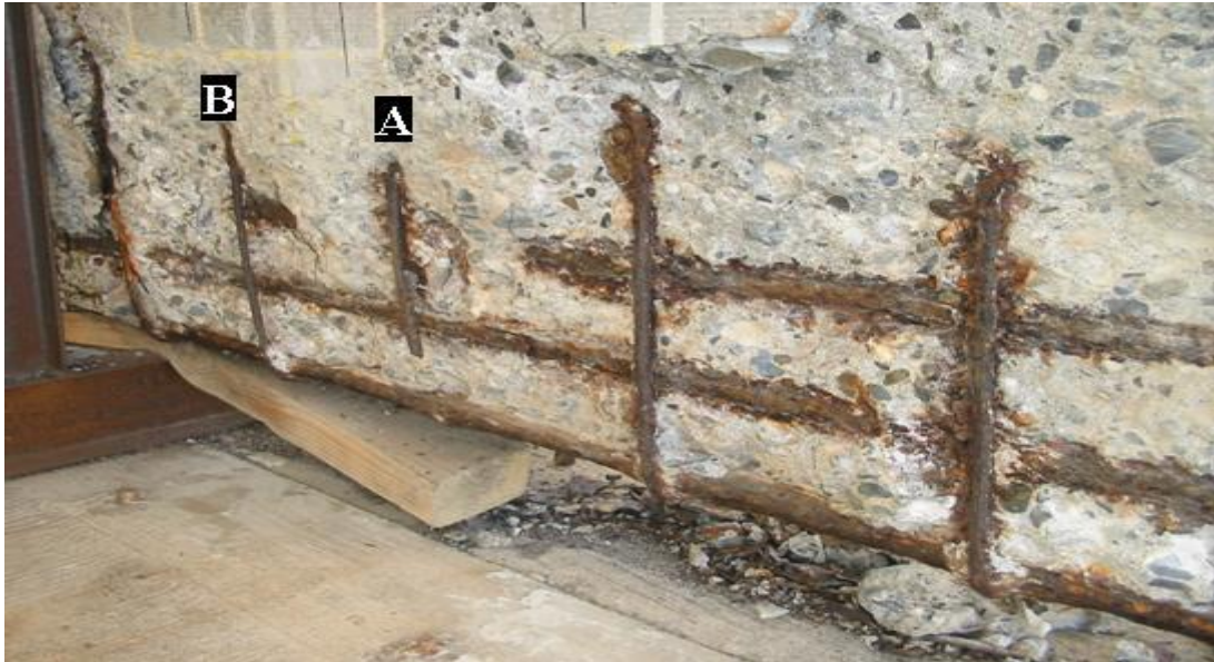
Slika 23.: Korozija u čelika u betonu (Izvor:[11])
