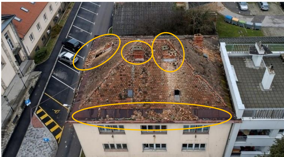
Slika 13. Oštećenja pokrova i krovne konstrukcije iz ptičje perspektive (16)
