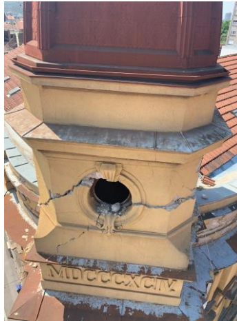
Slika 14. Primjer oštećenja konzolnih elemenata koji prijete urušavanjem (15)
