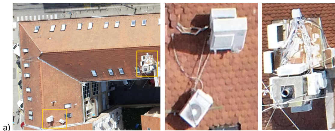
Slika 43. (a) Opći pogled na promatrani objekt ; (b) Instalacije neadekvatno pričvršćene na krovnu konstrukciju na visini iznad prolaza i balkona; (c) Visoki dimnjak (konzola) s neprikladnom količinom instalacija
