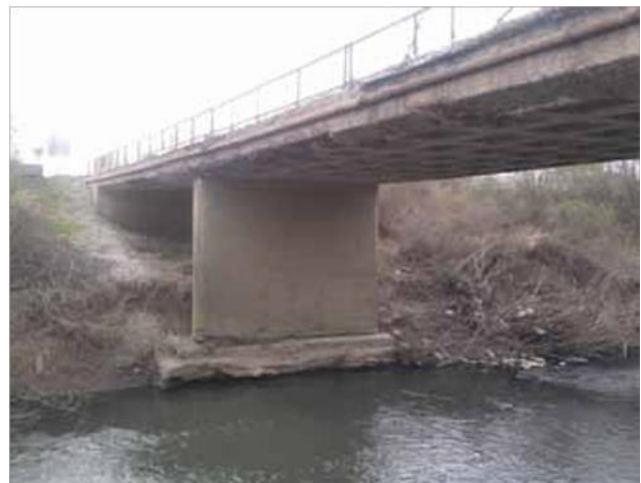
Slika 7.: Most s vidljivim znakovima podlokavanja temelja stupa podvrgnut ocjenjivanju (Izvor: [17])
