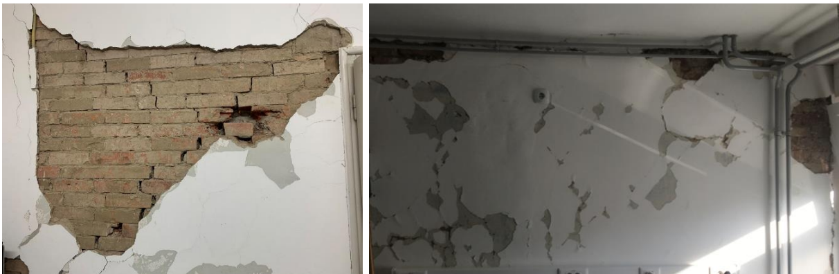
Slika 10.: Karakteristična oštećenja građevine nakon potresa [7]
