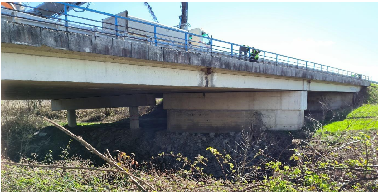
Slika 20. Pogled na most prije sanacije sa zapadne strane
