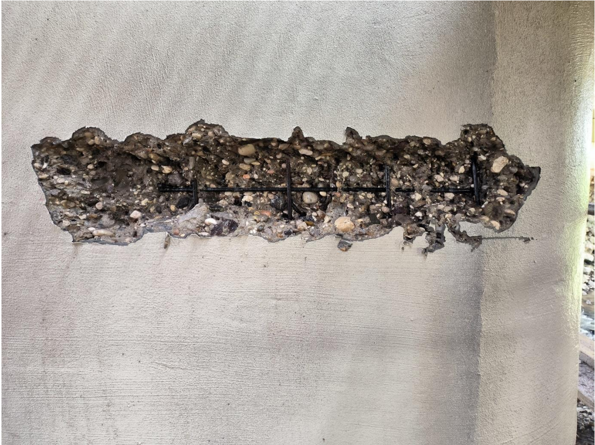
Slika 45. Uklonjeni površinski sloj betona
