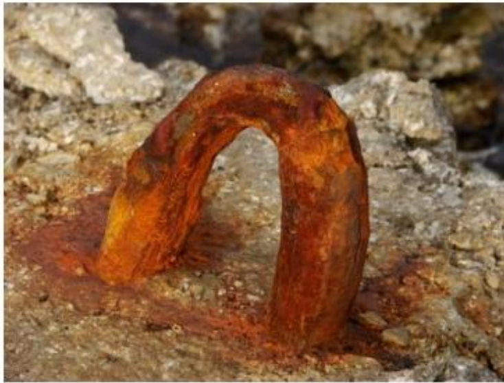
Slika 3.: Primjer kemijske korozije [7]
