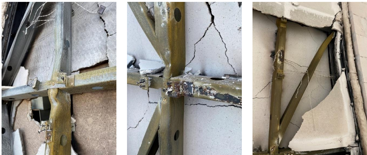
Slika 24: a) Čvor 6 nakon ispitivanja b) Čvor 10 nakon ispitivanja c) Čelična dijagonala između čvorova 8 i 11 nakon ispitivanja Panela 1
