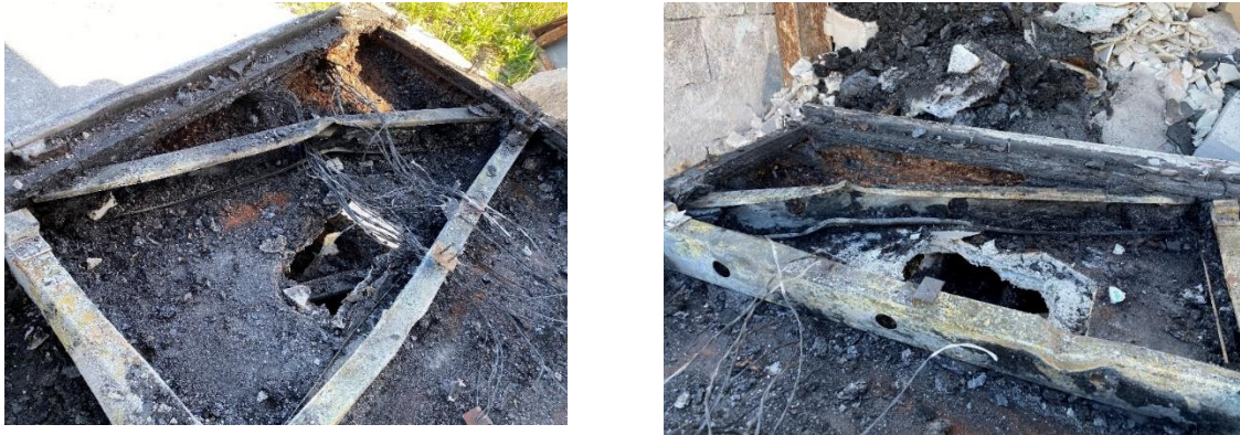
Slika 36: a) Dijagonala između čvorova 2 i 5 b) Dijagonala između čvorova 3 i 8
