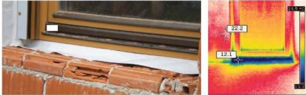
Slika 24: Primjer nepravilne ugradnje prozora
