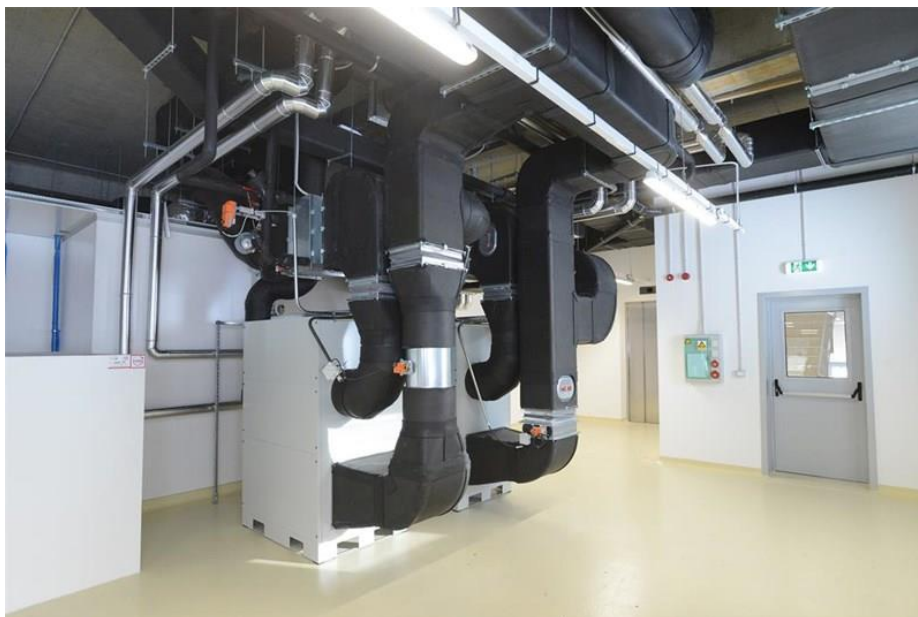
Slika 13. HVAC instalacije u Belupovom pogonu (Klimaoprema, 2022)
