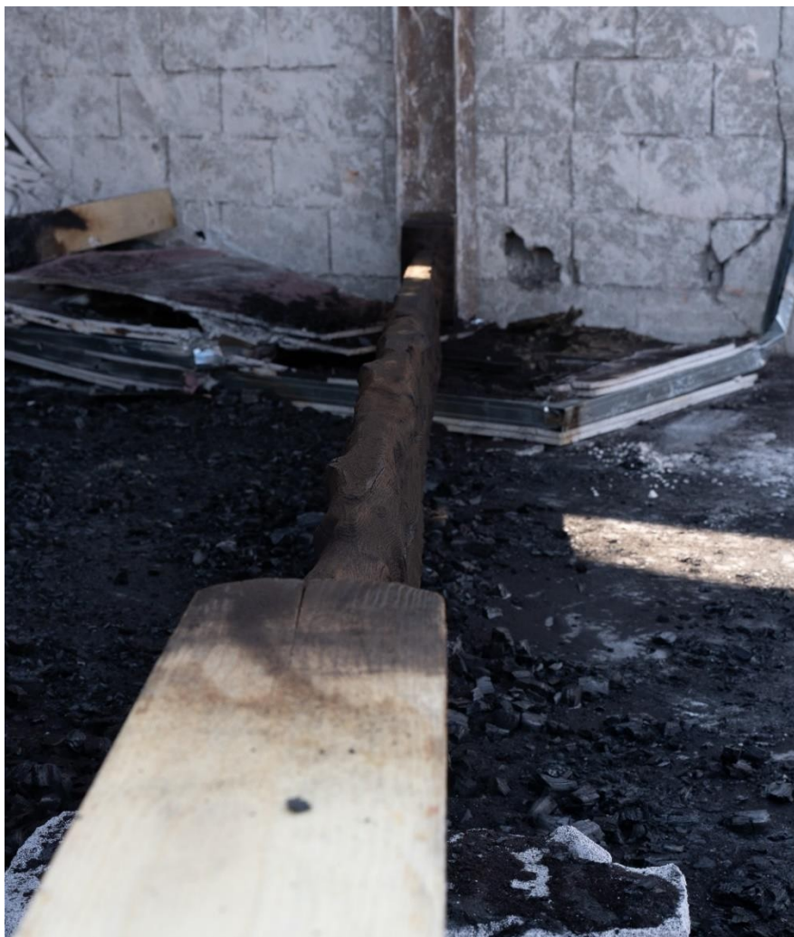
Slika 4.53 Normalna greda nakon čišćenja pougljenog sloja
