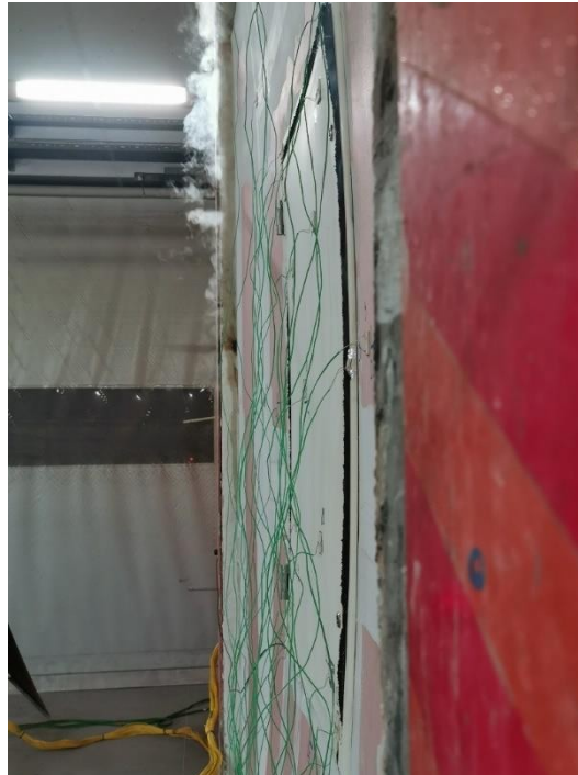
Slika 36. Manja deformacija požarnih revizijskih vrata
