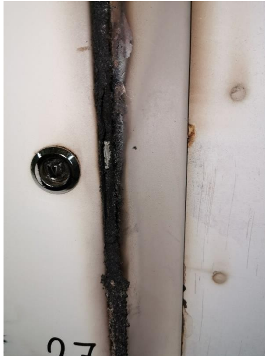
Slika 38. Tamni okvir požarnih revizijskih vrata
