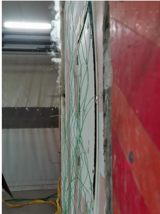
Slika 36. Manja deformacija požarnih revizijskih vrata
